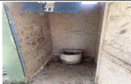
Foto 2: Piso de sanitarios con rajaduras.
