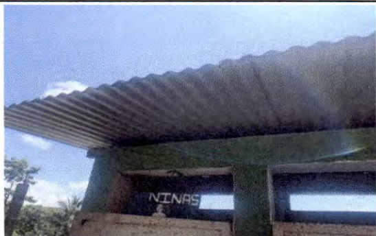
Foto 7: Láminas onduladas desgastadas.
