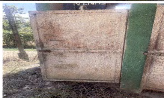
Foto 11: Puertas de sanitarios oxidadas.
