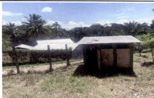
Foto 8: Servicios sanitarios en malas condiciones.
