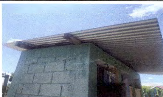
Foto 5: Estructura de madera en malas condiciones.
